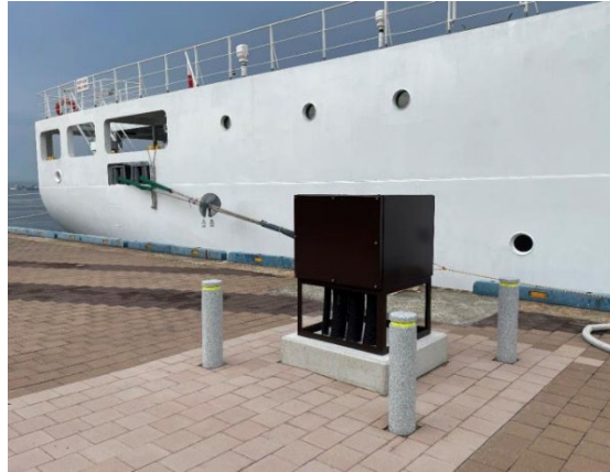
写真 神戸港の陸上電力供給設備
