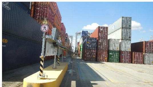
写真 2 バスバー(陸上給電設備)※
