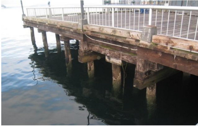
木杭の経年劣化による損傷
